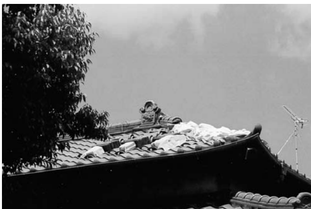
震度5で壊れた屋根瓦(松伏町内)
