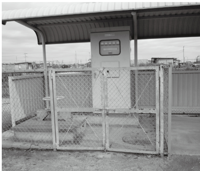
浸水した配電盤
