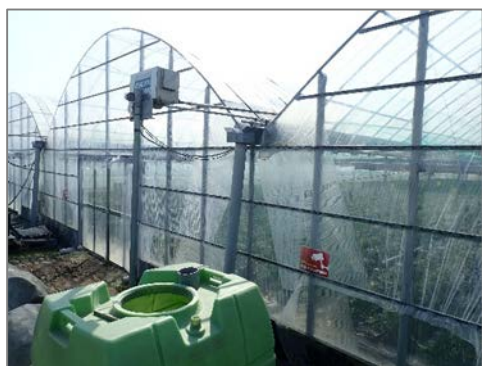
防犯カメラの設置
