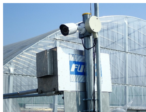
防犯カメラの設置
