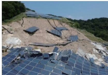
〈土砂流出による設備の崩壊〉
